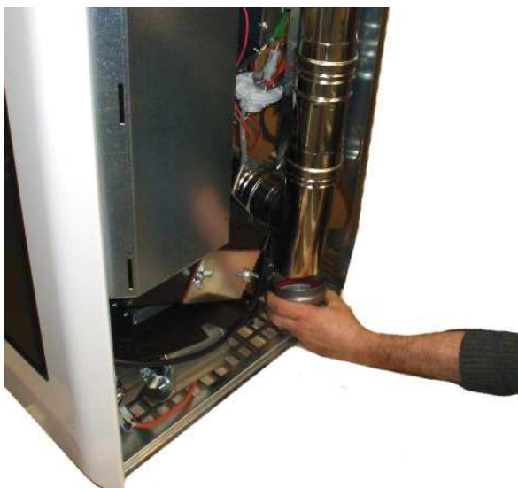
Fig. 49 - Nettoyage du collecteur des fumées
