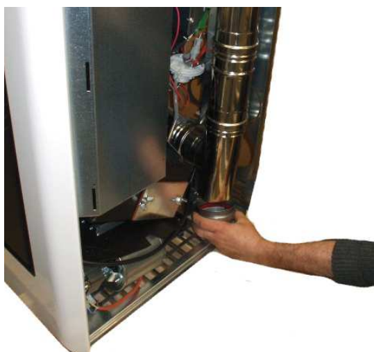
Fig. 40 - Pulizia canale da fumo
