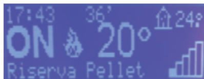
Fig. 22 - Réserve de granulés de bois
