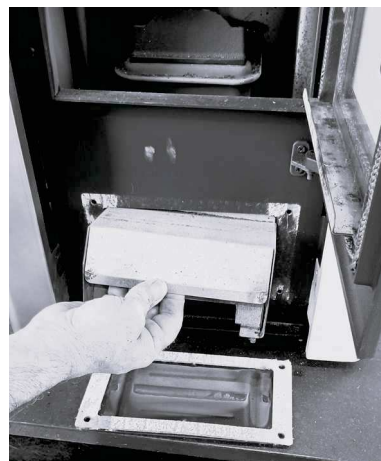
Fig. 27 - Den Inspektionsstopfen entfernen
