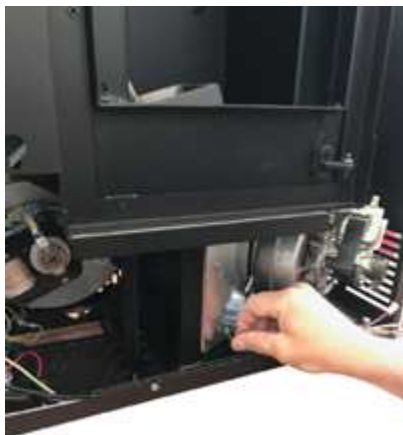
Fig. 89 - Retire la tapa de inspección
