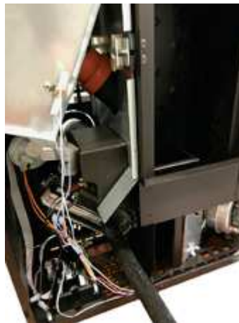
Fig. 94 - Limpieza ventilador ambiente
