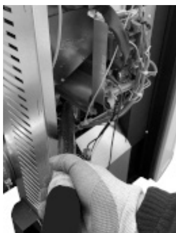
Fig. 74 - Nettoyage de le ventilateur ambiant
