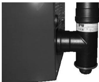
Fig. 53 - Pulizia canale da fumo
