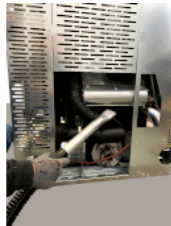
Fig. 58 - Reiniging van de kamerventilator 2
