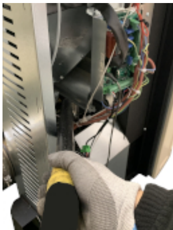
Fig. 57 - Reiniging van de kamerventilator
