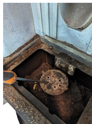
Fig. 42 - het schoonmaken van de vuurpot
