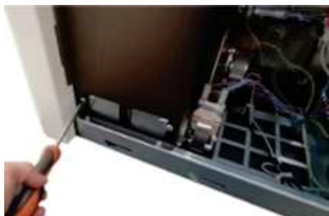
Fig. 68 - Limpieza ventilador ambiente
