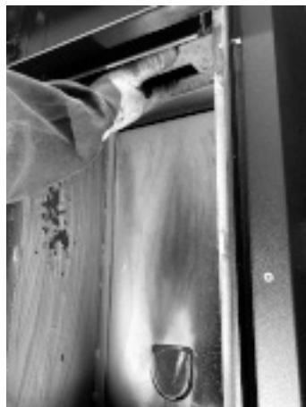
Fig. 56 - Die Stirnseite des Feuerraums 1 entfernen
