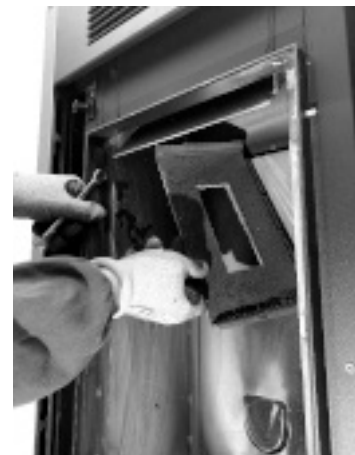
Fig. 57 - Die Stirnseite des Feuerraums 2 entfernen
