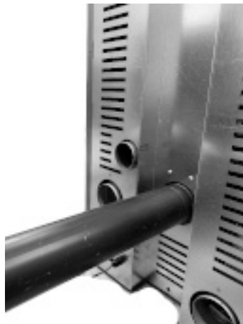
Fig. 28 - Le conduit d'évacuation
