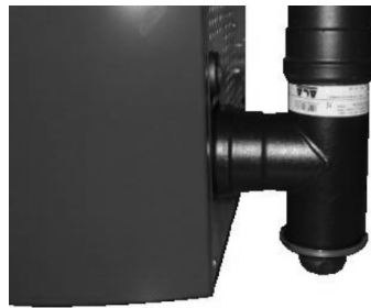
Fig. 71 - Fume conduit cleaning
