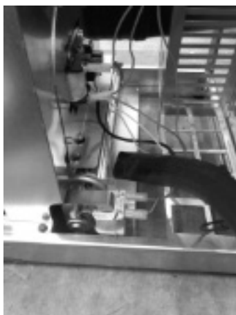
Fig. 88 - Nettoyage de le ventilateur ambiant
