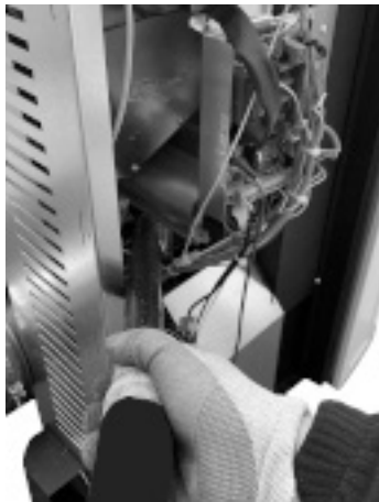
Fig. 129 - Room fan cleaning
