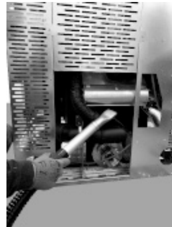
Fig. 130 - Room fan cleaning
