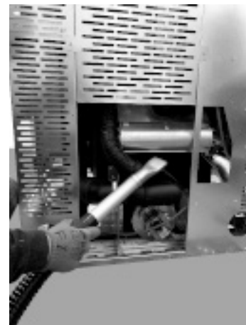
Fig. 138 - Nettoyage de le ventilateur ambiant
