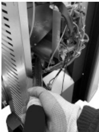
Fig. 137 - Nettoyage de le ventilateur ambiant
