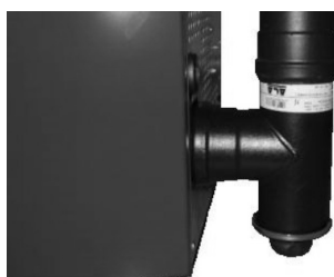
Fig. 67 - Pulizia canale da fumo
