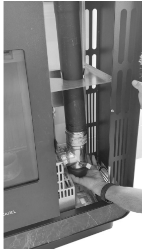
Fig. 65 - Fume conduit cleaning
