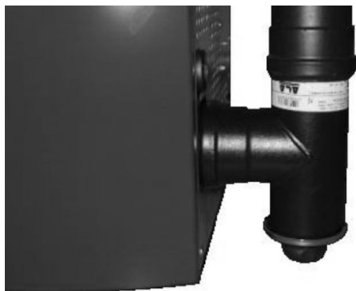
Fig. 22 - Fume conduit cleaning
