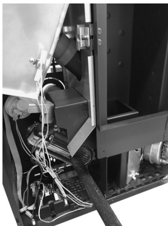
Fig. 74 - Limpieza ventilador ambiente
