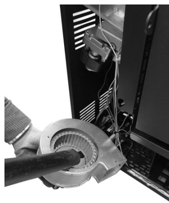
Fig. 76 - Limpieza del ventilador ambiente
