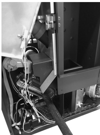
Fig. 81 - Nettoyage de le ventilateur ambiant
