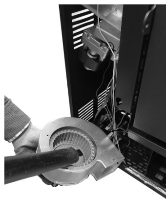
Fig. 83 - Nettoyage du ventilateur d'ambiance
