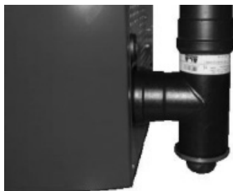
Fig. 66 - Pulizia canale da fumo
