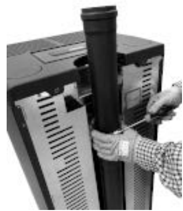
Fig. 72 - Rookgassenafvoer achteraan gemonteerd
