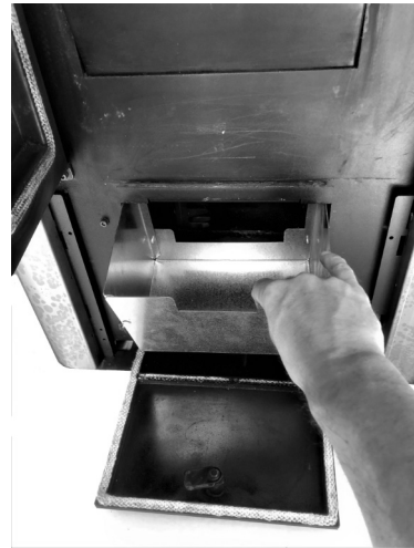
Fig. 57 - Den Inspektionsstopfen entfernen
