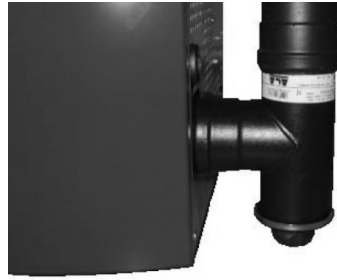
Fig. 53 - Fume conduit cleaning
