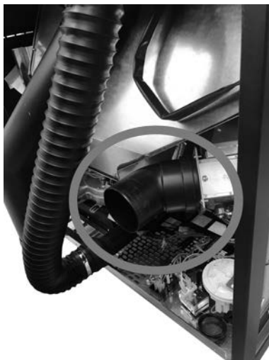
Fig. 36 - Plaats de 45° koppeling aan de kachel
