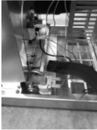
Fig. 32 - Room fan cleaning
