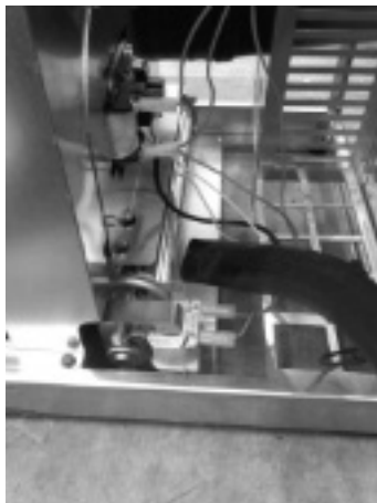
Fig. 35 - Nettoyage de le ventilateur ambiant
