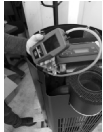
Fig. 65 - Conexión del presostato digital
