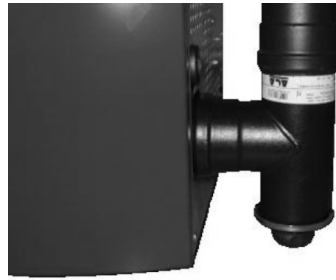
Fig. 64 - Fume conduit cleaning
