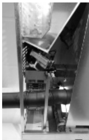
Fig. 61 - Sortie de fumées postérieure Sharp
