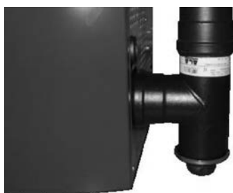
Fig. 37 - Pulizia canale da fumo
