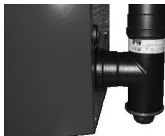
Fig. 83 - Fume conduit cleaning
