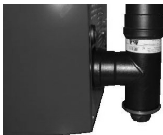
Fig. 39 - Pulizia canale da fumo
