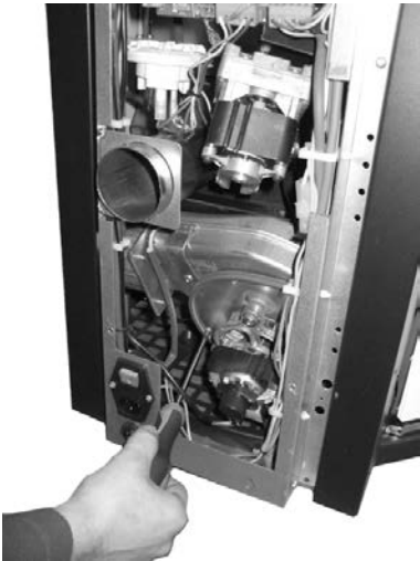
Fig. 111 - Limpieza del aspirador de humos: fase 1
