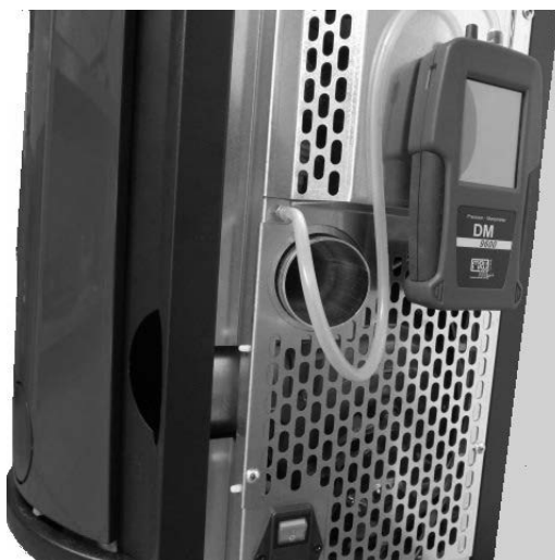
Fig. 62 - Conexión del presostato digital
