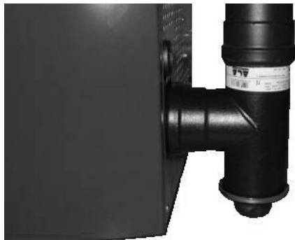
Fig. 85 - Pulizia canale da fumo
